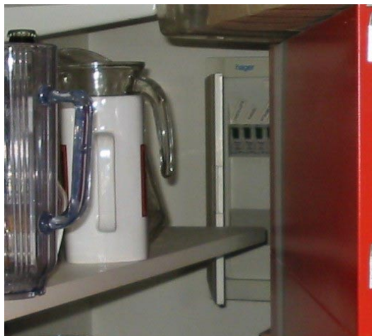
Mynd 8. Óaðgengileg rafmagnstaflu.
